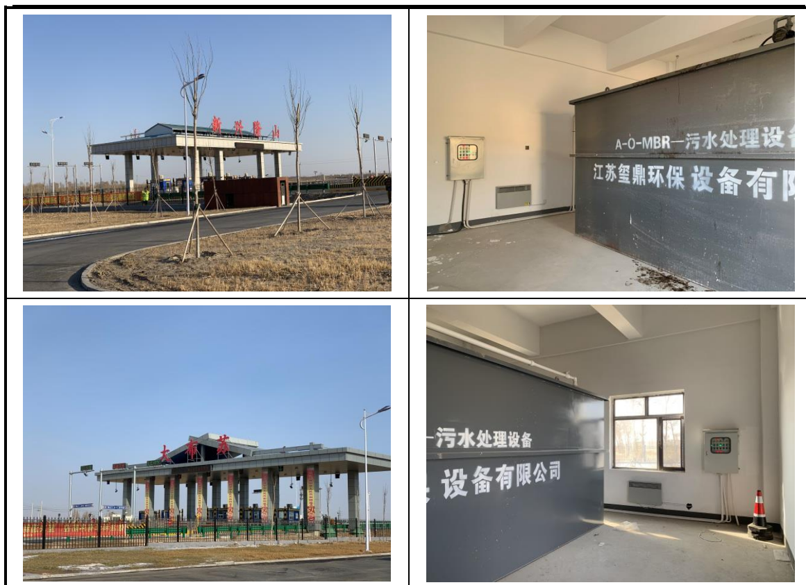
图 7.3-2 污水处理设施
