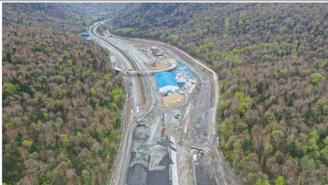
龙蒲 4 标古洞河服务区，施工单位利用服务区场地进行施工生产生活区的建设，避免了新增临时占地。
