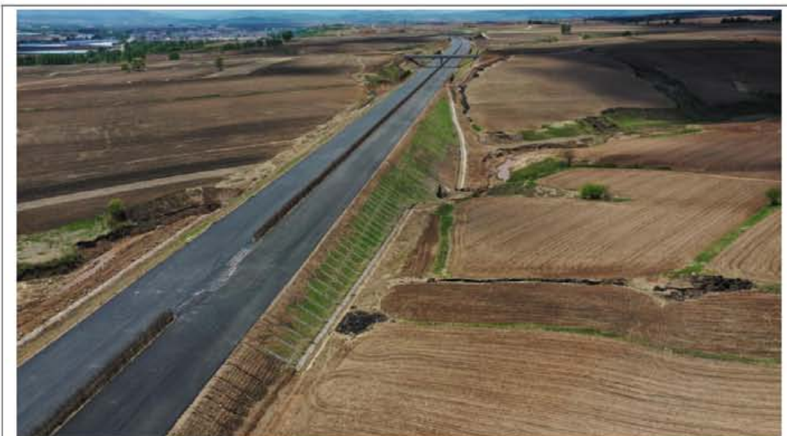
龙蒲 1 标 K33+800 主线路基填方边坡实施叠拱防护及植草绿化等措施；中央分隔带实施场地平整，植草植灌绿化等措施；坡脚实施边沟排水沟等措施。
