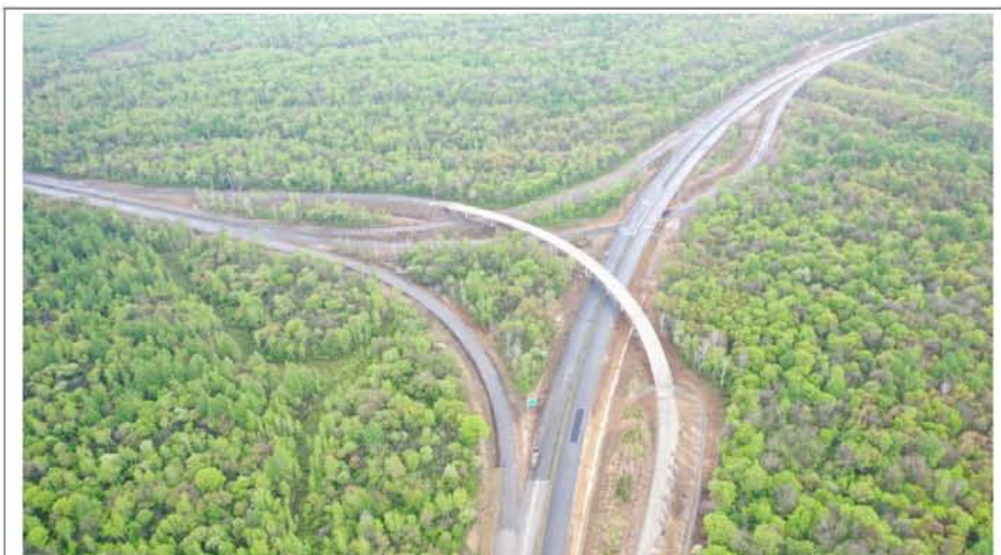
龙蒲 7 标 K128+413 池北互通在施工过程中，最大程度保护原生植被；填方边坡实施叠拱防护，植草绿化；坡脚实施边沟排水沟。
