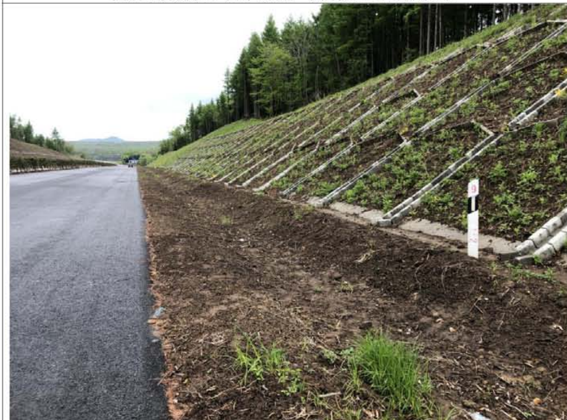
龙蒲 7 标 K132+900 主线路基挖方路基实施叠拱防护，表土回覆和植草绿化；坡脚实施排水沟等措施。
