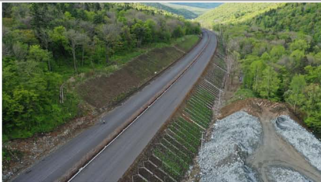
龙蒲3标 K77+500 主线路基挖方边坡实施叠拱防护，表土回覆，植草绿化措施； 填方边坡实施叠拱防护，表土回覆，植草绿化措施，坡脚实施边沟排水沟。
