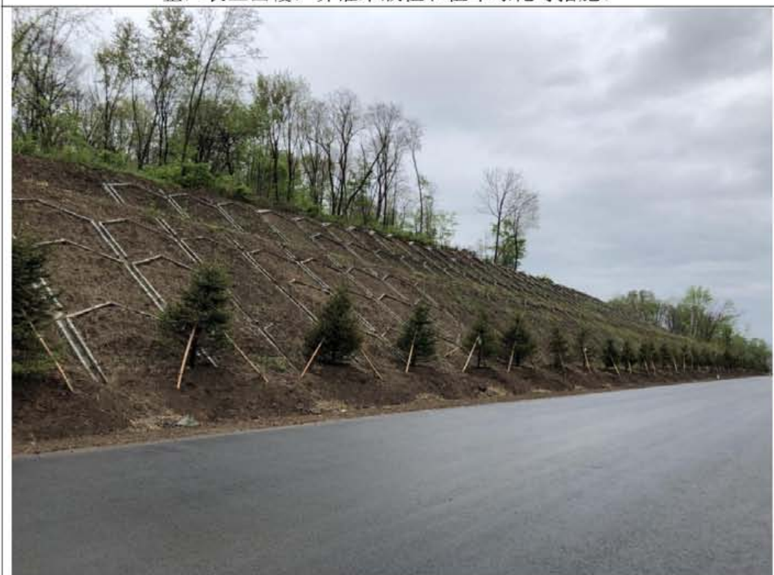
龙蒲 8 标 K146+100 主线路基挖方边坡实施叠拱防护，表土回覆和植草绿化，路侧实施乔灌木栽植；坡脚实施边沟排水沟等措施。
