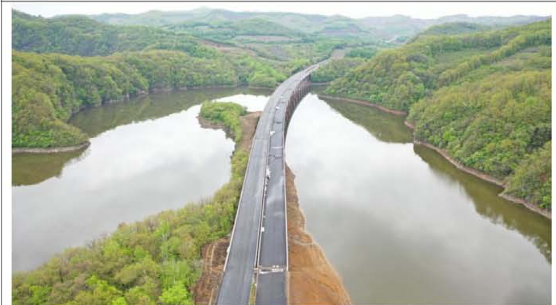
龙蒲 7 标 K131+892 五道白河大桥施工结束后实施桥下迹地平整，植草绿化；边坡实施坡面修整，植草绿化。
