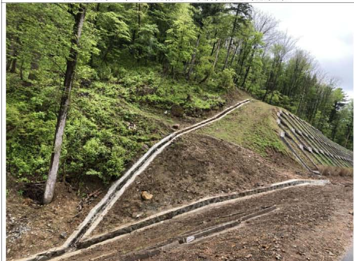
龙蒲 5 标 K100+800 主线路基挖方边坡实施叠拱防护及植草绿化等措施；路侧实施栽植乔木；坡顶坡脚实施截水沟、坡脚实施边沟排水沟等措施。
