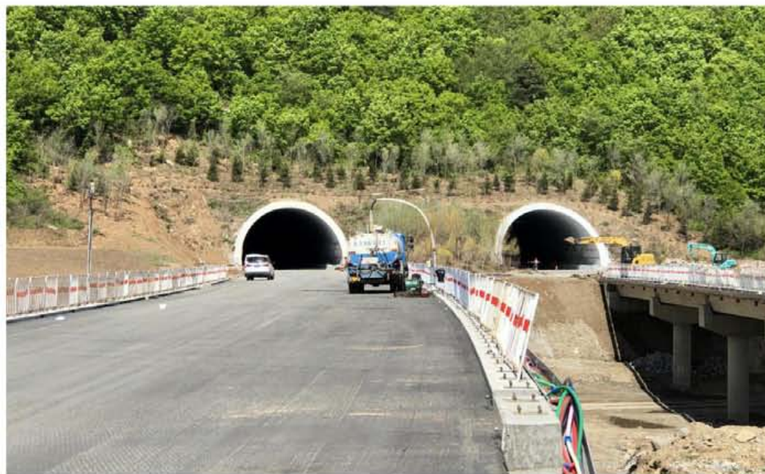
龙蒲 1 标 K51+600 明岩隧道出口洞顶坡面实施乔灌木栽植和植草绿化，坡顶设置截水沟。
